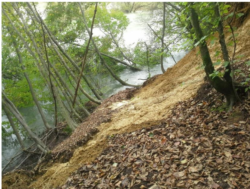
Slika 1. a) vrh klizišta uz stambenu zgradu b) oštećenje ceste uzrokovano klizištem c) stopa klizišta uz rijeku Dobru
